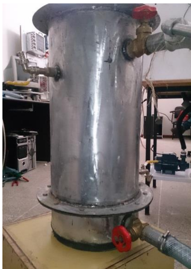
Fig.13: Actual storage Tank.
